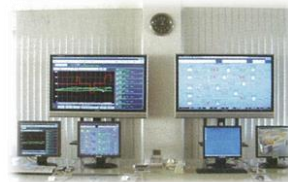
中央監視装置（市内全域の監視） ・各施設の運転状況や送水量を常時監視
