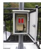
非常用コンセント
