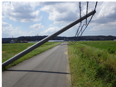
令和元年台風第15号による電柱倒壊の状況(木更津市内)
