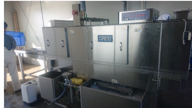
カゴ洗浄設備
