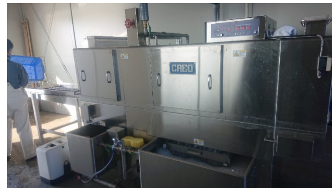
カゴ洗浄設備
