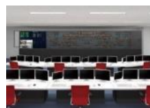
中央給電 指令所システム
