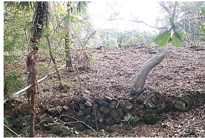
【堤体の古い石垣に木が根付いている】
