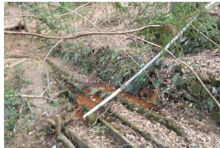
【堤体から漏水・側溝に葉や土が堆積】
