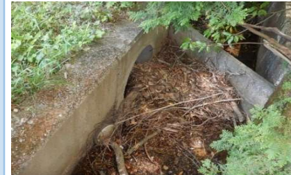
※点検時に洪水吐から下流へつながる管口に葉や土の堆積を確認
