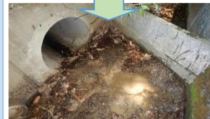
※撤去することで豪雨時の被害を防止 (注) 津市提供資料による。
