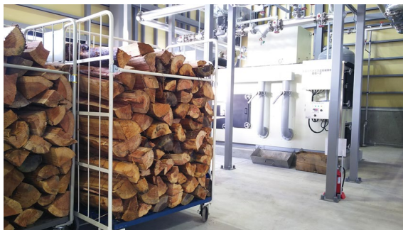
運用しているボイラーと薪
