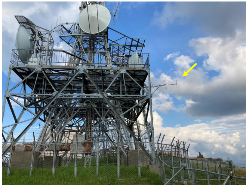
図 5.2-6 送信装置のアンテナ設置状況(長野県松本市 美ヶ原局)
