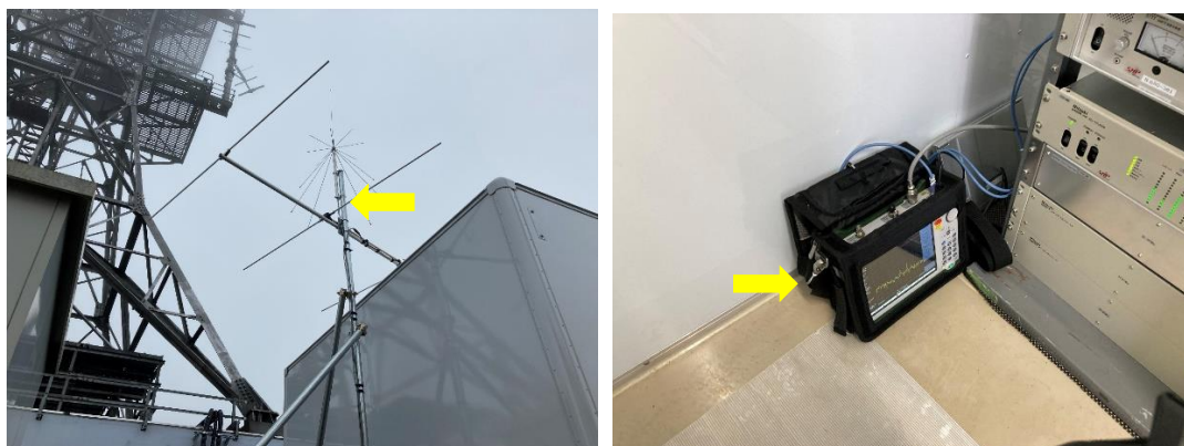
図 5.4-2 高ボッチ局における機器設置状況 (左図:設置した広域空中線、右図:測定用スペクトラムアナライザ)
