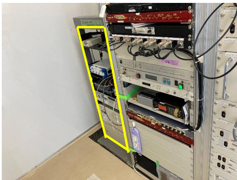
図 5.2-9 受信装置の受信機器設置状況(長野県塩尻市 高ポツ局)
