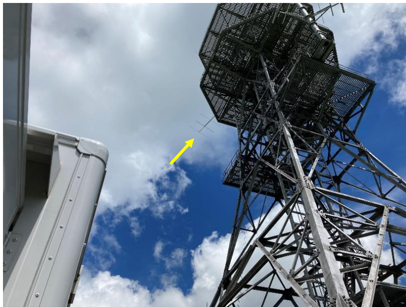
図 5.2-8 受信装置のアンテナ設置状況(長野県塩尻市 高ポツ局)
