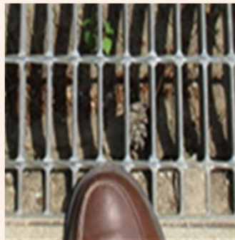
②溝蓋の隙間が広過ぎる例 (奈良国立博物館)
