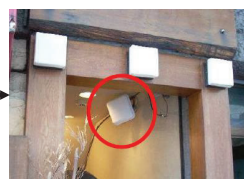
基地局電波を受信するアンテナ (ドナーアンテナ)
