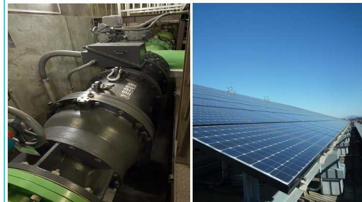
小水力発電設備・太陽光発電設備
