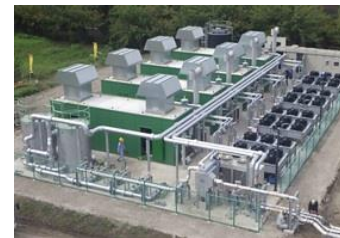
バイオガス発電機
