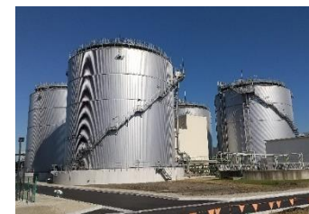
汚泥消化タンク
