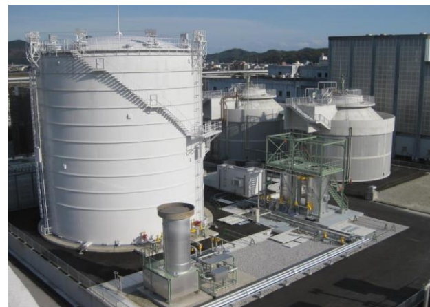
汚泥消化施設
