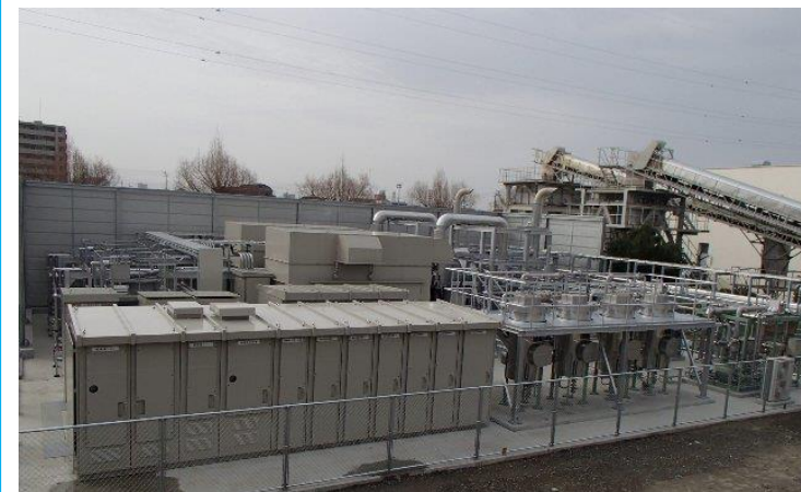
消化ガス発電施設の外観
