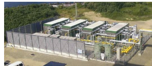
宜野湾浄化センター消化ガス発電施設
