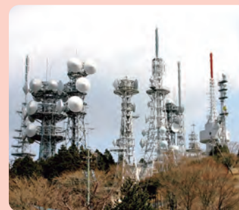
各種無線通信用鉄塔
