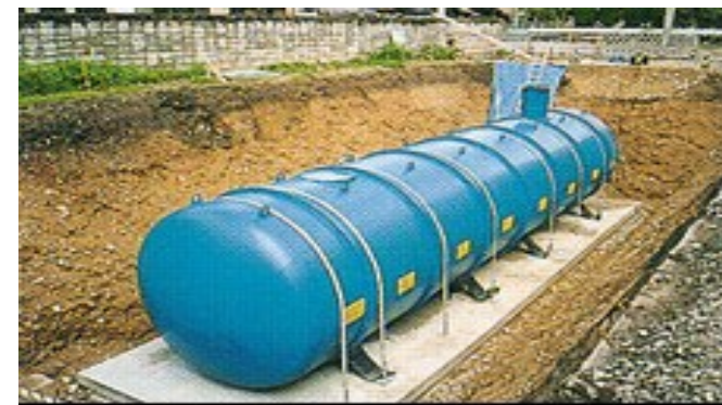
【耐震性貯水槽】
