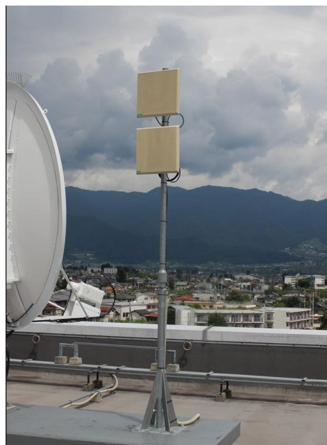
市役所屋上に設置されたLPWA受信拠点
