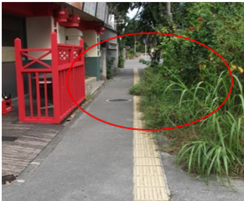
事例④-6 場所：市道 那覇市（牧志1丁目 重点整備地区） 誘導用ブロックに草木が覆い被さっている
