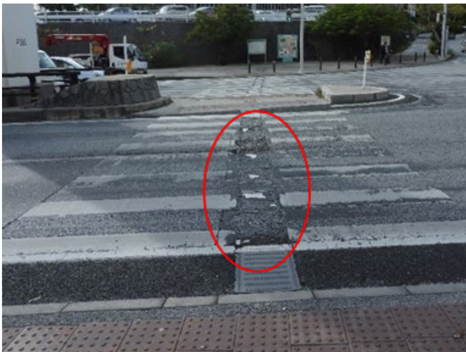
事例⑧-1 場所：国道330号 那覇市（おもろまち駅前交差点）
