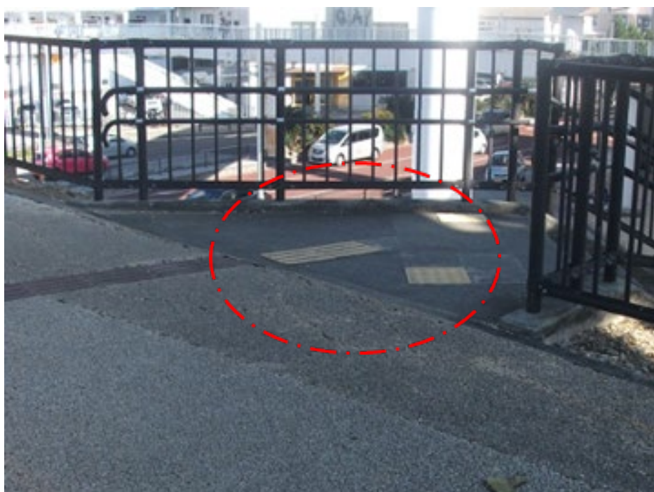
事例①-4 場所：国道330号 那覇市（古島インター） 階段前の誘導用ブロックが剥離している
