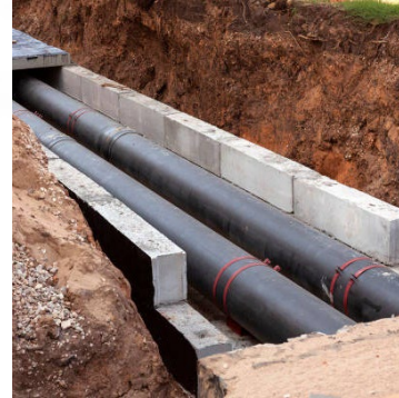
管路 約60万km
