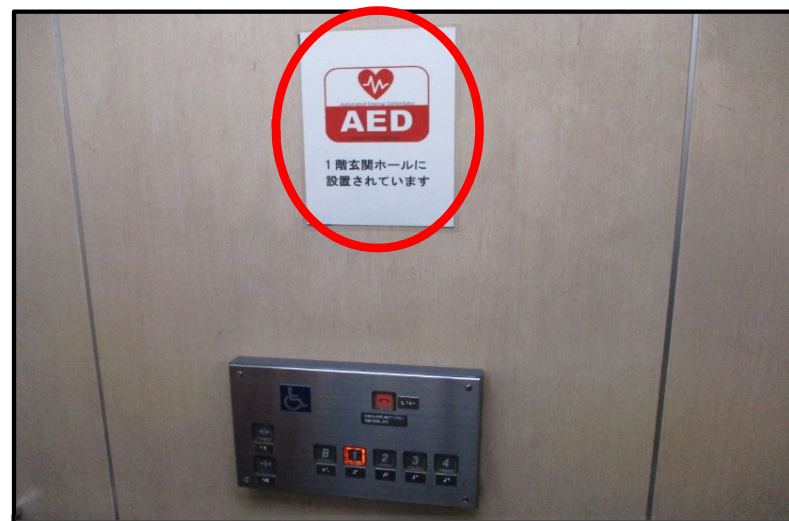
エレベーター内
