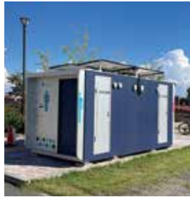
太陽光発電で運転、浄化処理可能な自己完結型トイレを東部交通公園に設置。
