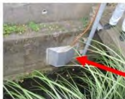
水位センサー設置 (例)
