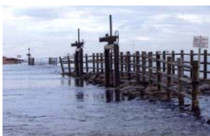
導流堤の老朽化による砂、海水の流入
