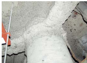
吹付けアスベスト
